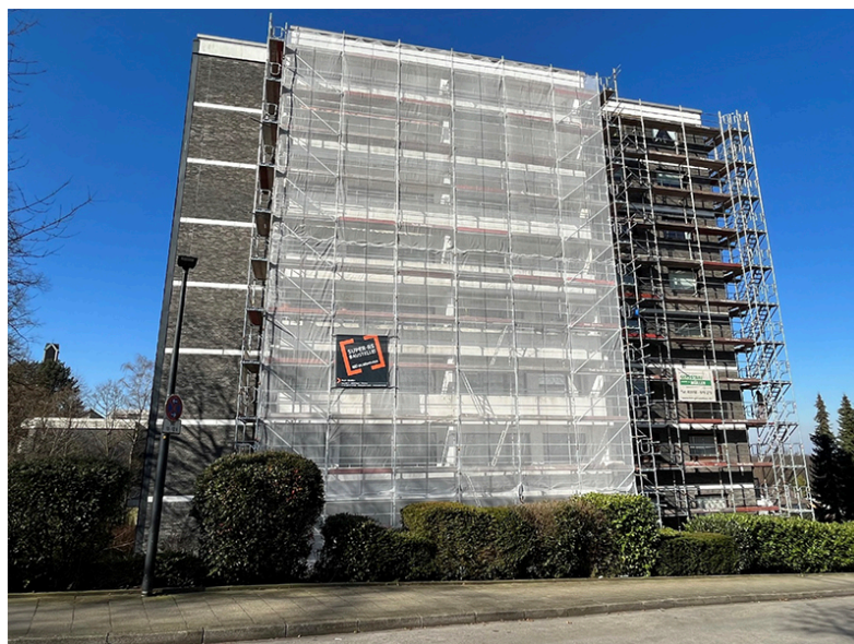
شکل ۱-۷- نمونه پرده‌های برزنتی یا شبکه پلاستیکی (توری) برای جلوگیری از پرتاب مصالح، ابزار و انتشار گرد و غبار
