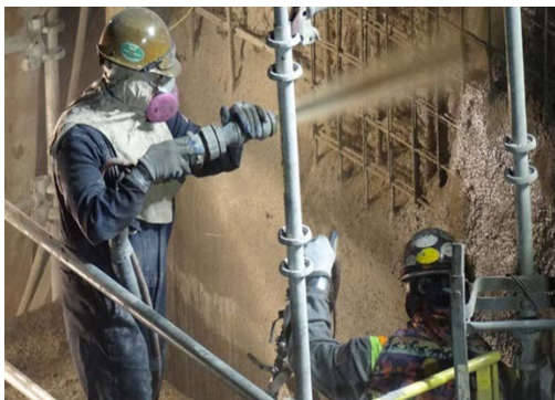
ب- انتشار گردوغبار حاوی ذرات معلق سیلیس / سیمان (در اثر عملیات پاشش بتن)
