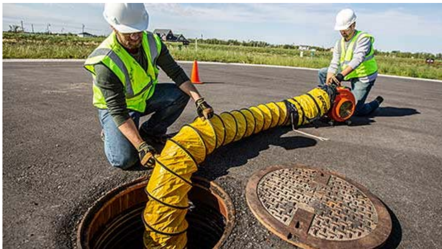
شکل ۳۴-۳- تجهیزات تهویه داخل چاه (فضای محصور)
