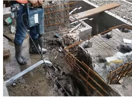
الف- تخریب موضعی
